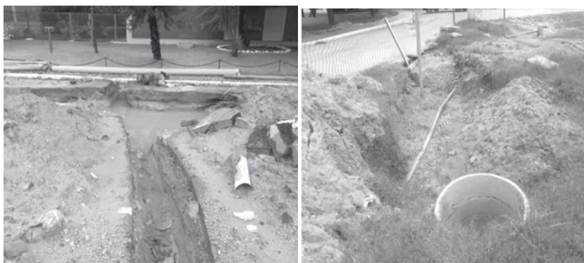
Figura 3: Obras de saneamento do Complexo da Avenida Brasil. Fonte: arquivo da autora.
